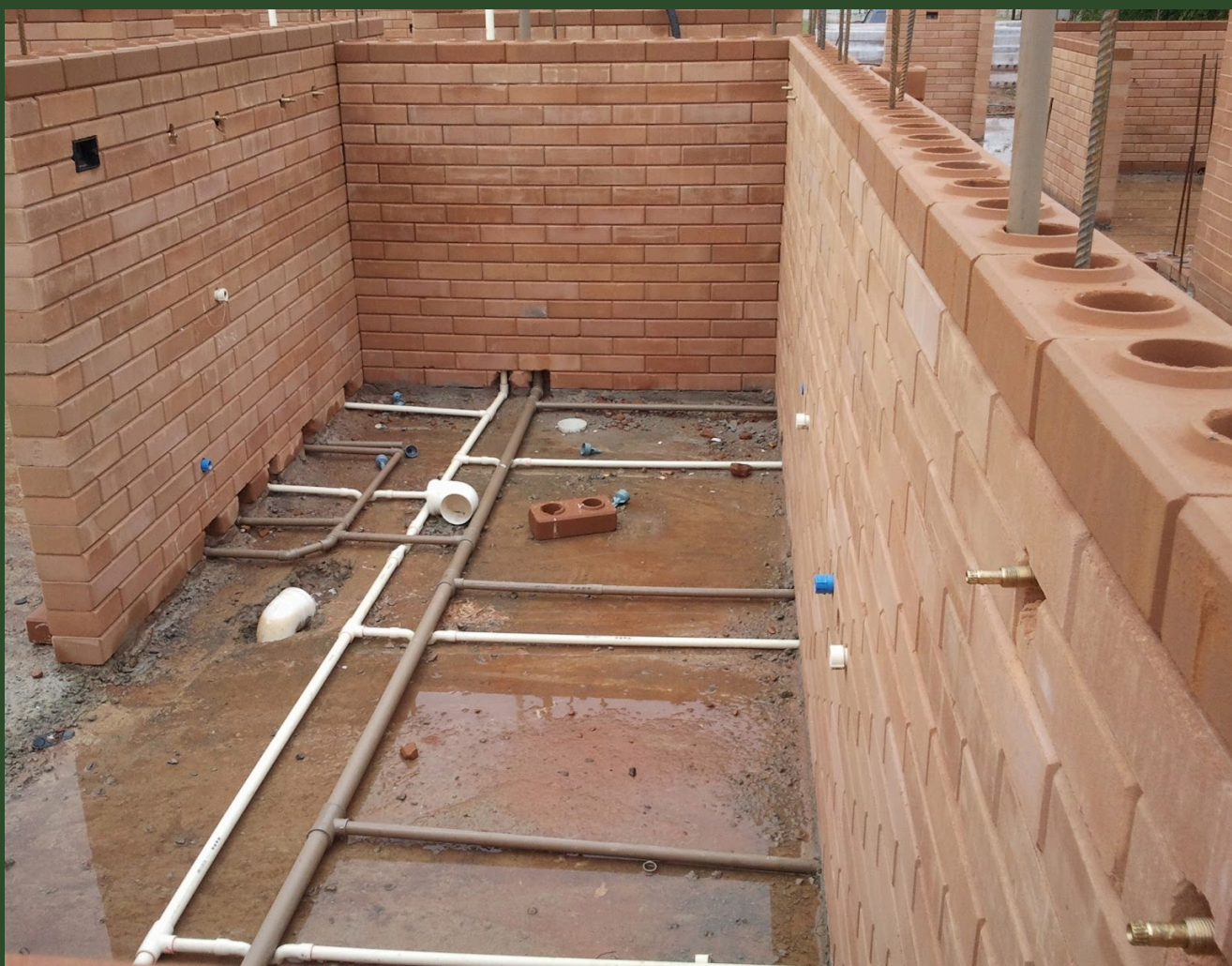
OBRA EM FASE INTERMEDIÁRIA · TUBULAÇÕES JÁ POSICIONADAS NOS FUROS ANTES DO FECHAMENTO DA FIADA.
